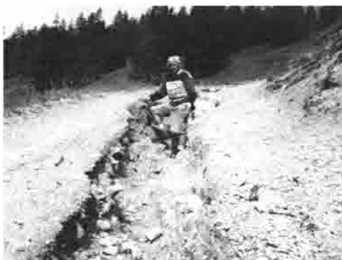
AN ALPENVEREINSWEGEN MUSSTEN AUCH 2004 UNWETTERSCHÄDEN BESEITIGT WERDEN.
