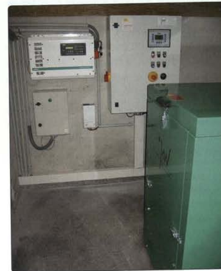
Sehr sauber „aufgeräumt“: Ein Blockheizkraftwerk
