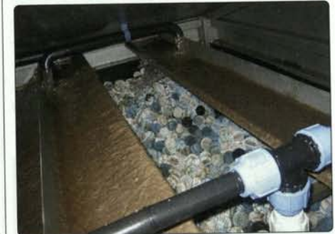
Tropfkörper mit Verteilereinrichtung
