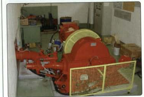
Turbine des Kleinwasserkraftwerks auf der Lienzer Hütte
