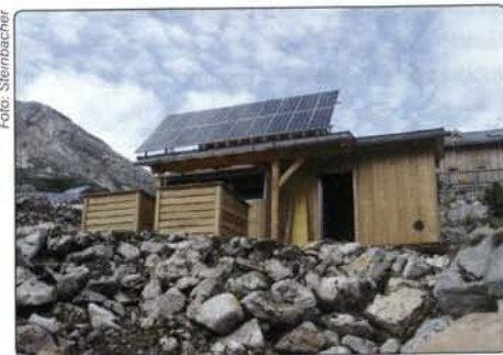
Photovoltaik-Anlage auf der Heßhütte
