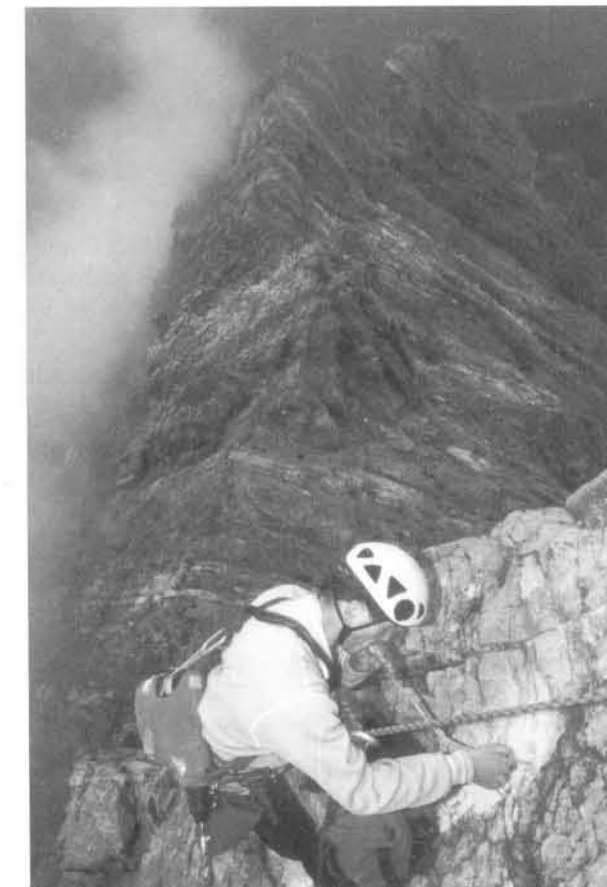
Olaf Perwitzschky beim Ausblasen des Bohrstaubes aus einem Bohrloch, vor dem Einkleben des Bohrhackens
