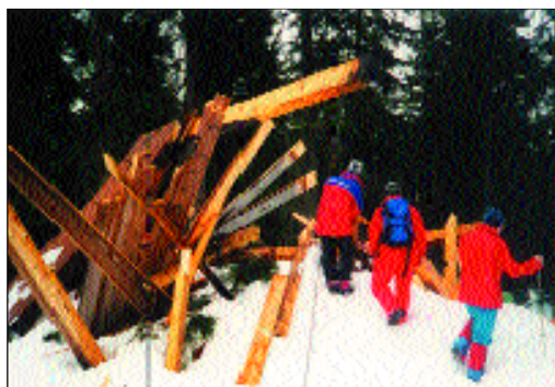
Die Bergwacht Krün besichtigt die zerstörte Talstation
