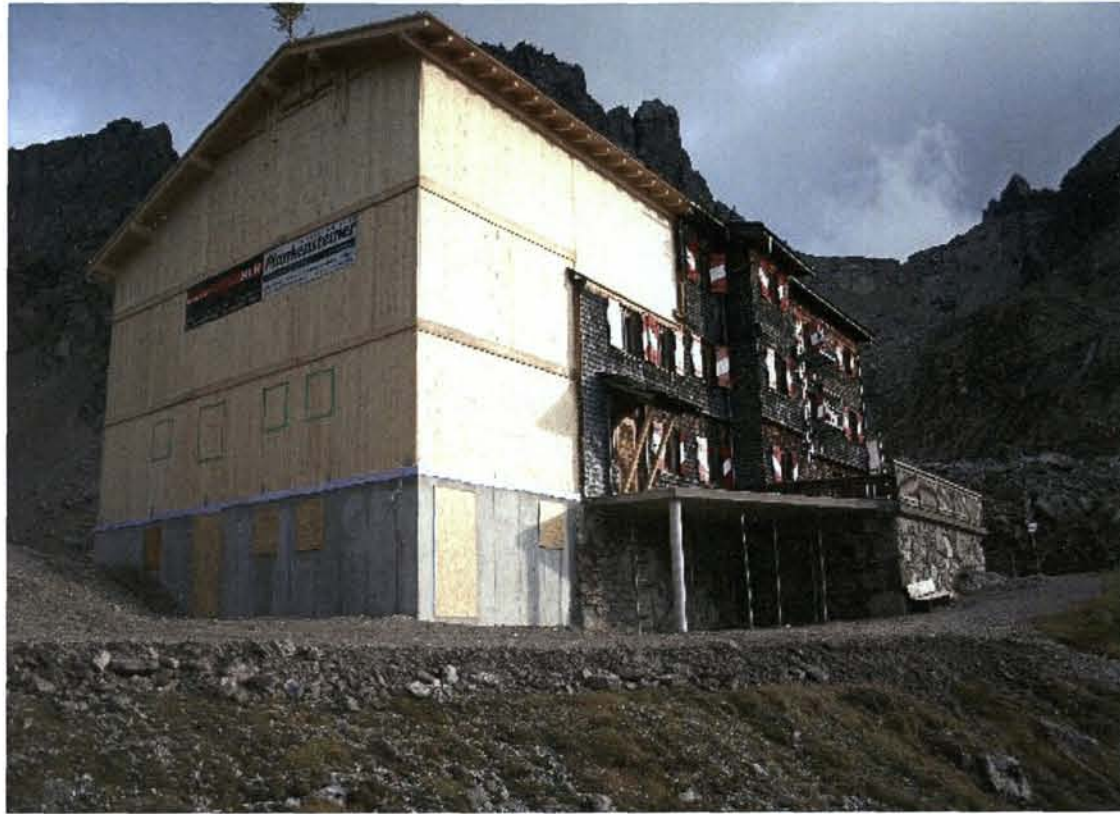
26. September 2006: Der neue Anbau ist winterfest hergerichtet - und das in nur einem Monat Bauzeit.
