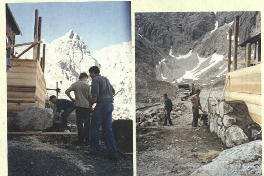
Nur ein kleiner Radlader diente den Helfern beim Erstellen der Terrasse als einziges technisches Hilfsmittel. Ein mühsames und schweres Arbeiten auf 2260 m war das Aufschieben der großen Steinbrocken.
