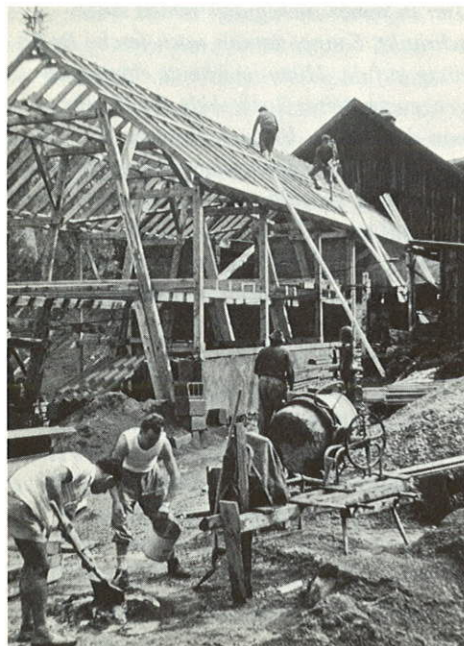
Der Erweiterungsbau (1. Bauabschnitt mit Bergstation, Schlafräumen und Waschanlagen) ist in vollem Gange
