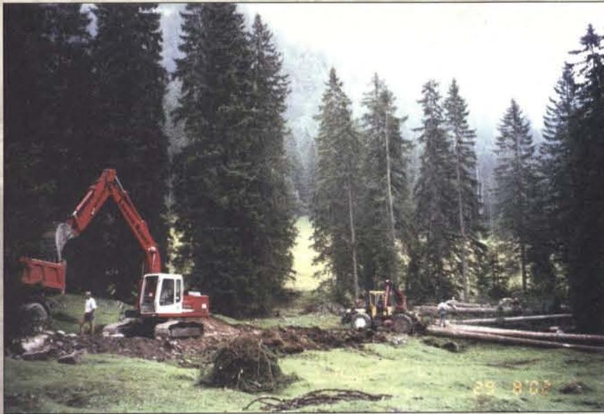
29.08.2002 Es entsteht der Zufahrtsweg und der neue Standort der Hütte wird gerodet.
