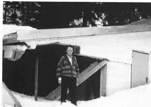
W. Löfflad vor der durch eine Lawine zerstörten Talstation
