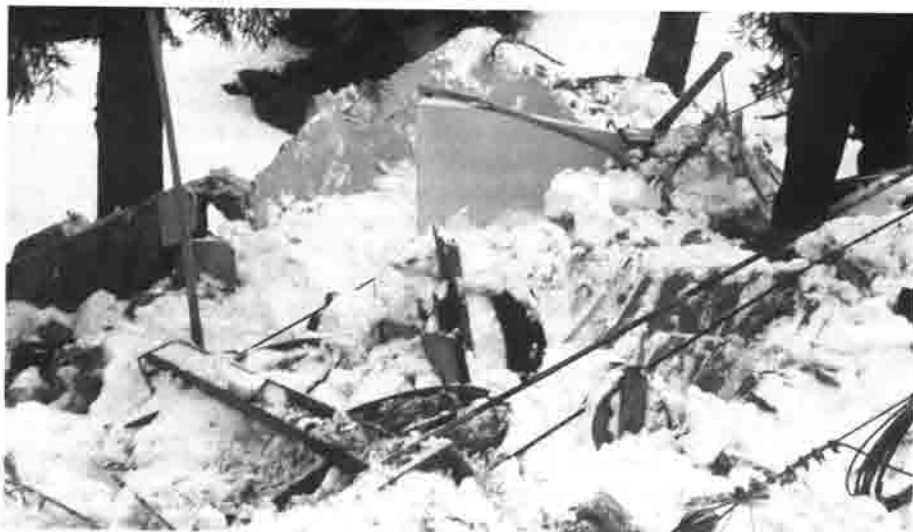
Die durch eine Lawine im Jahre 1984 zerstörte Talstation der Materialseilbahn
