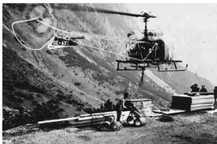
Der Hubschrauber bringt das auf dem Hahntennjoch gelagerte Baumaterial hinauf zur Baustelle.
