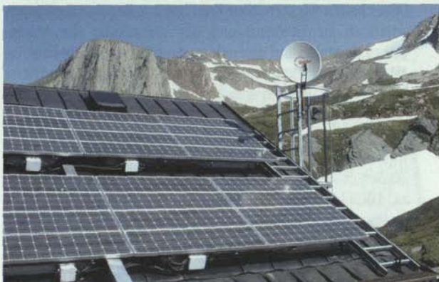
Photovoltaik-Anlage, Wellach im Hintergrund
