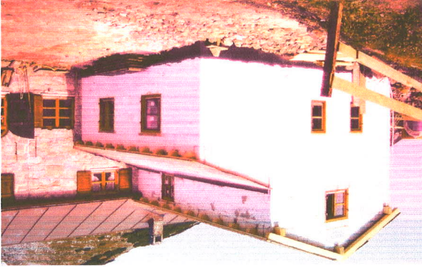
Farchanter Anbau wird abgerissen. Rohbauerstellung des neuen Küchenbaus durch Fa. Forst-und Alpinbau Mangold, Eschenlohe.
