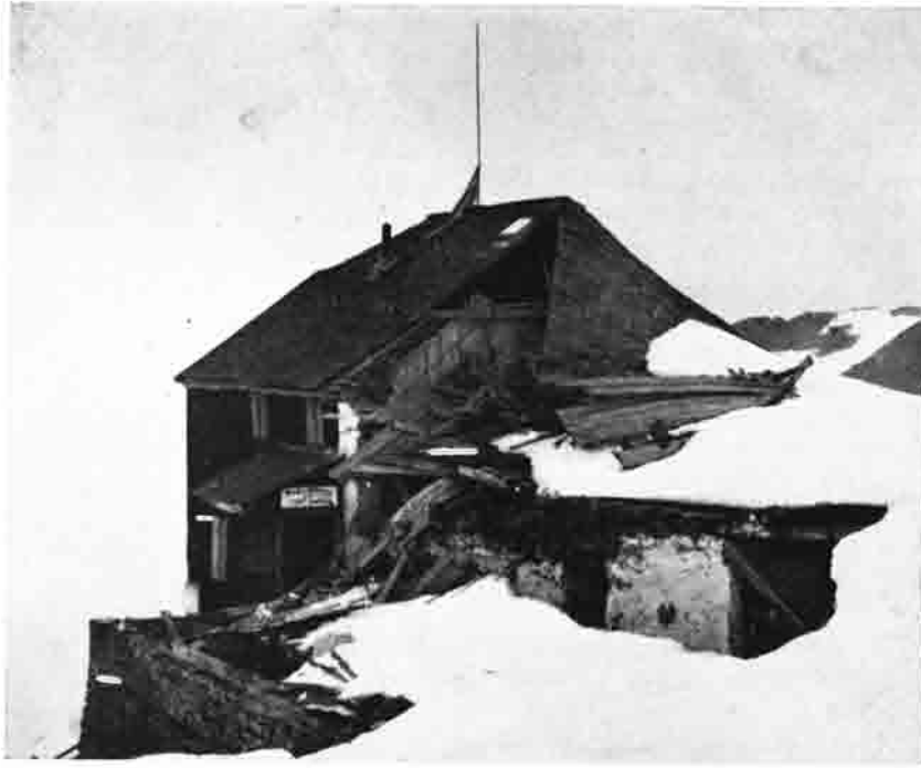
Edel-Hütte nach dem schweren Lawinenschaden 1951
