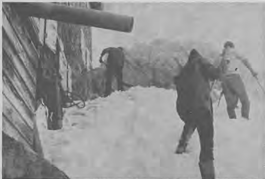
Bis fast zum zweiten Obergeschoß haben sich in vergangenen Jahren Eis und Schnee verfestigt. Bei Tauwetter dringt das Wasser in das Haus. Fotos: Fred Noak
