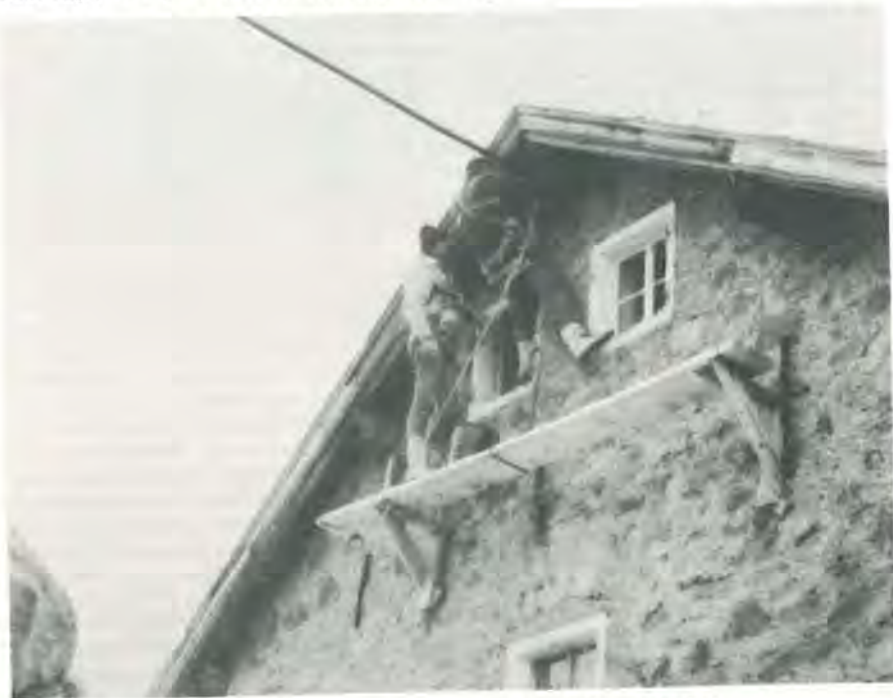
Bei der Prüfung des Daches — ungesichert wird hier nicht gearbeitet.
