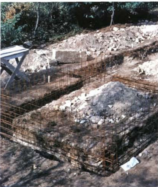
Das einzige bislang aufgefundene Bild vom Rohbau des Kletterturmes zeigt die für das Betonieren vorbereiteten Fundamentgräben. Foto: Udo Preugschat
