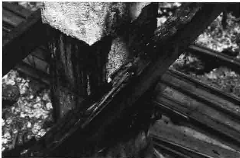
Nach dem Abtragen des Daches zeigten sich die beträchtlichen Schäden des Dachstuhles. – Die Gefahr des Einsturzes des Daches bestand, wenn man bedenkt, wie schwer die meterhohe Schneelast ist.
