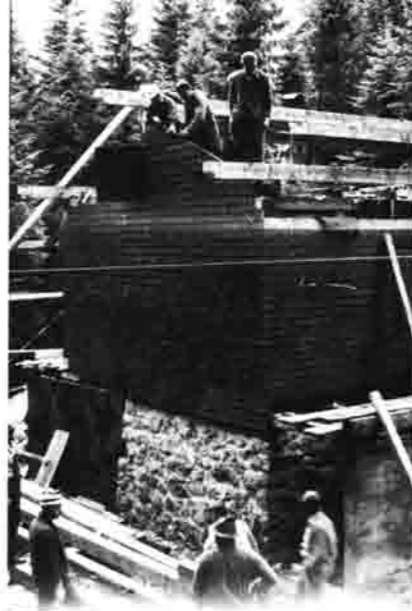
Keine leichte Arbeit, die schweren Dachbalken mit Muskelkraft an ihre Stelle zu transportieren.
