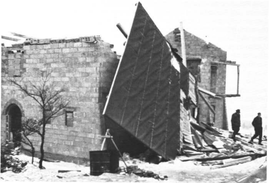
Im Januar 1954 wurden von einer schweren Sturmbö das Dach der Enzianhütte weggerissen und die Giebelmauern beschädigt.
