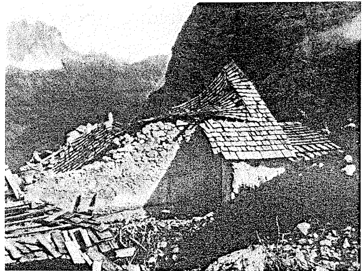
1. Pfalzgauhütte (nach der Zerstörung)
