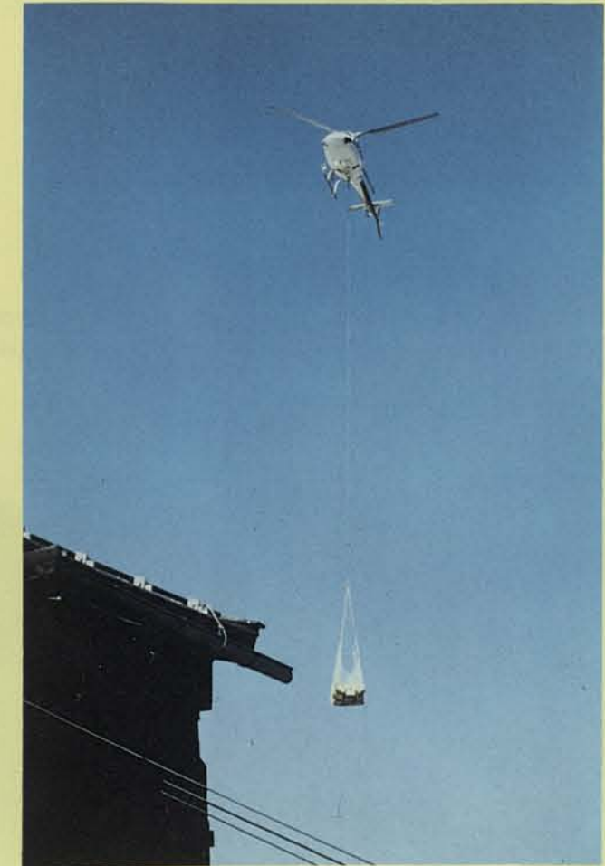
Der Hubschrauber mit einer Ladung Dachschindeln, verstaute in einem Transportnetz, im Anflug auf die Baustelle.
