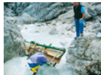
Weggespülte Brücke am Stangensteig
