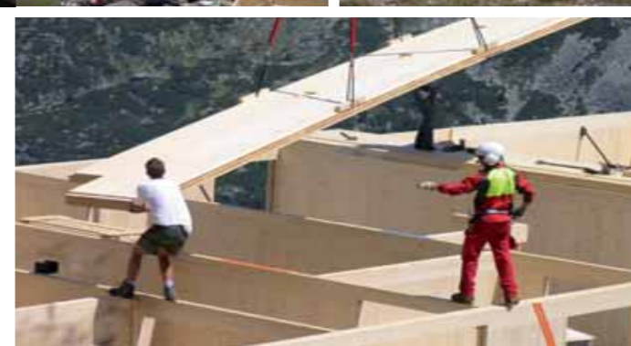
Bauleiter Ernst Pfeifer und Architekt Hermann Kaufmann (rechtes Bild) beobachten den Fortgang der Bauarbeiten.
