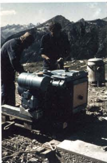
Nachdem die Hüttenbeleuchtung früher mit Gas betrieben worden ist, soll nun ein Dieselaggregat die erforderliche Energie liefern.
