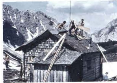
Reparaturarbeiten am Dach der alten Hütte sind nach dem Winter erforderlich geworden
