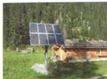
Wackeralm: Kitzbühler Photovoltaikanlage
