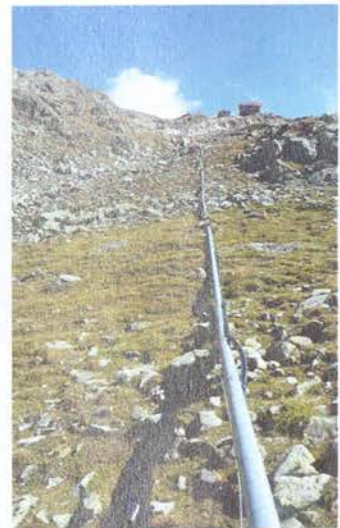
Siegerlandhütte: Druckleitung zum Wasserkraftwerk
