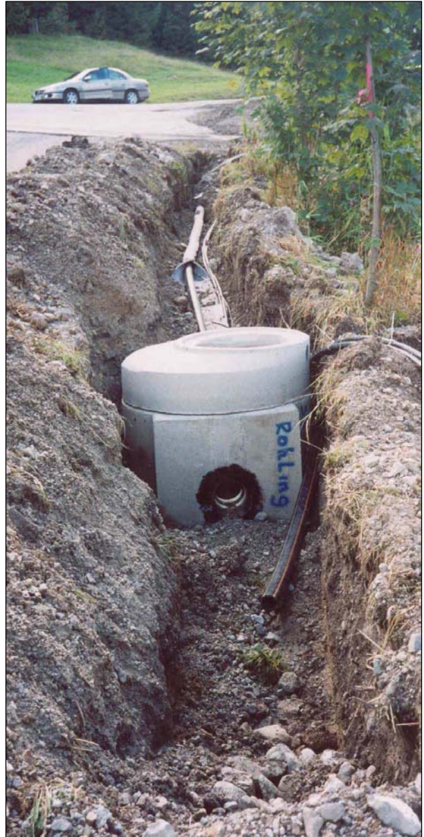
Der Abwassersammelschacht Rechenau.
