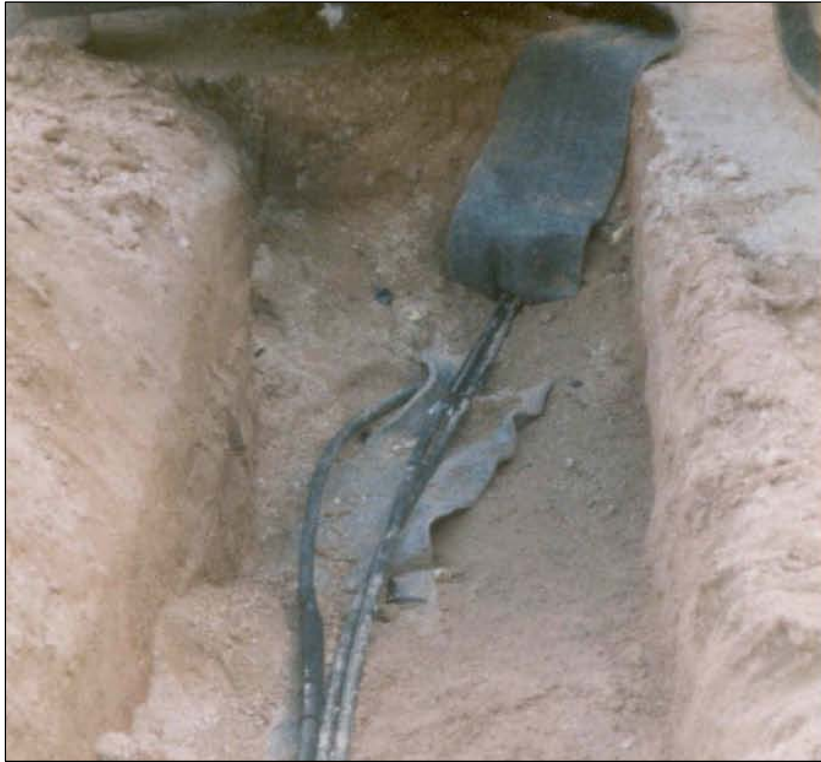
Die 1. 20 kV-Muffe von oben
