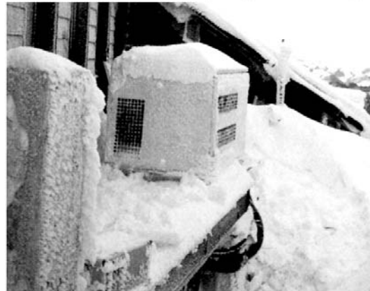
Extreme Bedingungen im Winter für die Wärmepumpe
