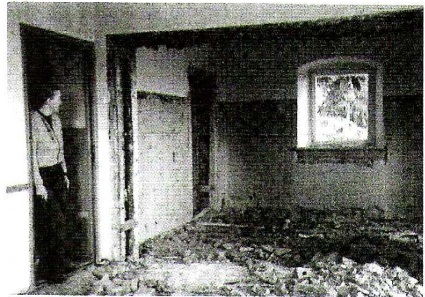
Hüttensanierung dritter Bauabschnitt (1981) Oben: Die Wirtin vor den Trümmern der Gaststube Unten: Neubau der Veranda
