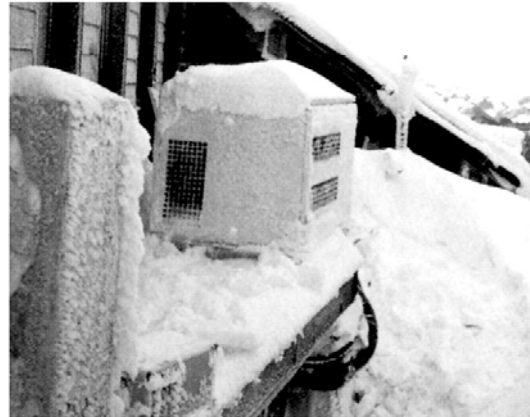
Extreme Bedingungen im Winter für die Wärmepumpe
