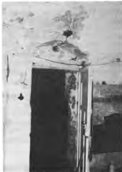
Bilder diese Seite: Eindrücke vom Zustand des DAV-Turmes vor der Instandsetzung
