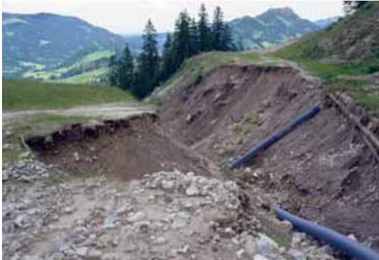
Bild 7: Massiver Erosionsschaden nach Geländeingriff
