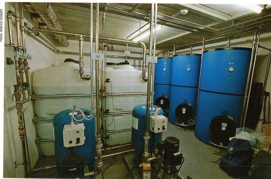
Warmwasser auf der Hütte gibt immer wieder zu Diskussionen Anlass. Warmwasseraufbereitung in der Capanna Cristallina/TI
