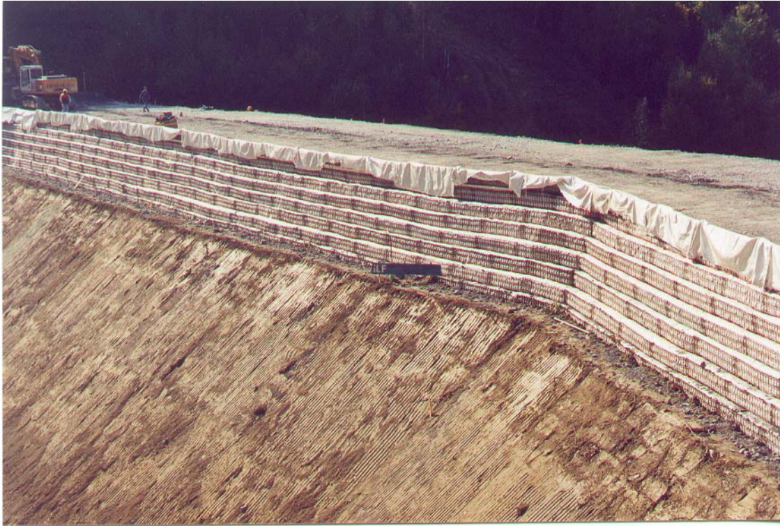
Abb. 6 Bewehrte Erde im obersten Abschnitt der Dämme Fig. 6 Reinforced soil in the uppermost layers of the dams
