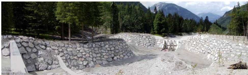
Abb. 2: Ausleitungsbauwerk hm 35,96 mit dem Retentionsraum und der Ausleitungsmulde am linken Ufer unmittelbar bachaufwärts der Sperre kurz nach der
