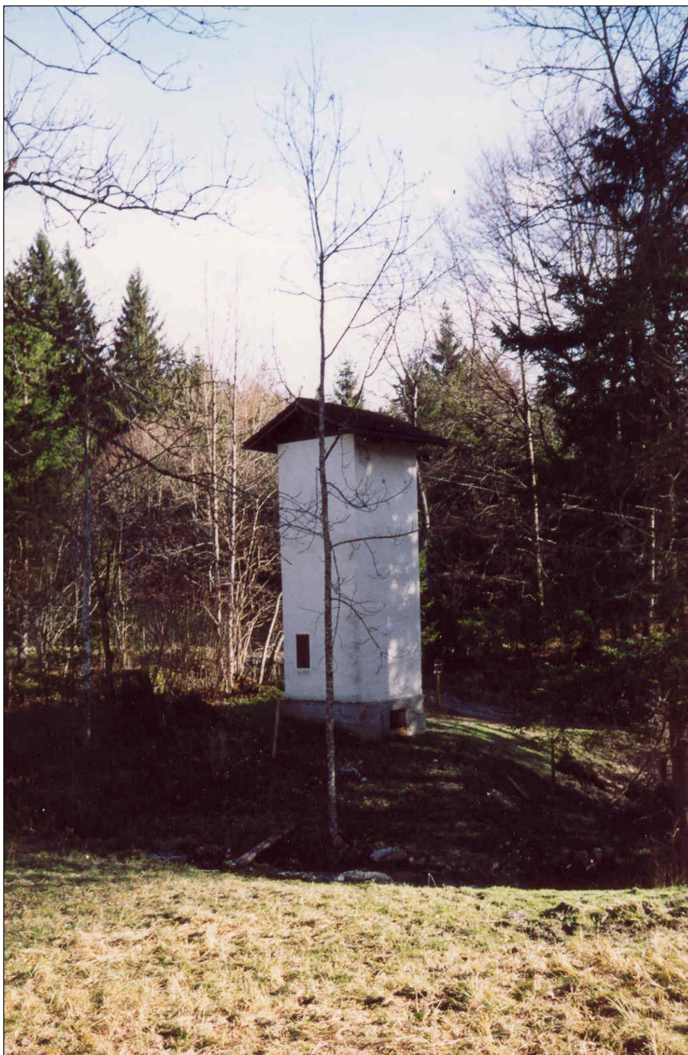
Die 20 kV-Freileitungsstation Wildgrub unterhalb Rechenau.
