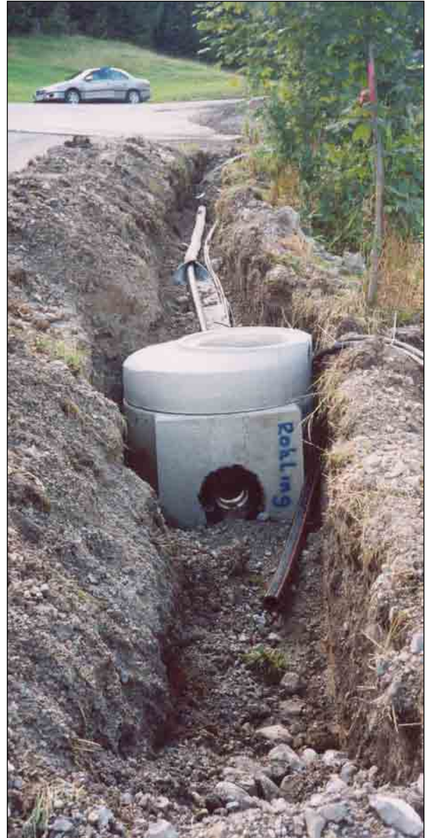
Der Abwassersammelschacht Rechenau.
