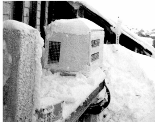
Extreme Bedingungen im Winter für die Wärmepumpe
